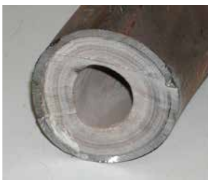
▲ 給水管線堵塞
